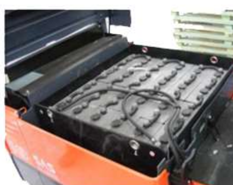
Bateria de acumulatori
